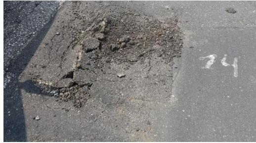
Imagen 7.3.1 Descascaramiento en pistas de aterrizaje
