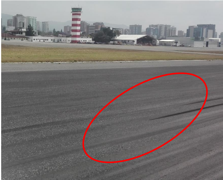
Imagen 7.2.4 Ahuellamiento en una pista
