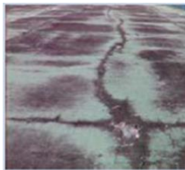
Imagen 7.6.6.1 falla por bombeo
