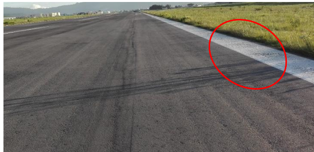
Imagen 7.1.3 Fisura de Borde de una pista
