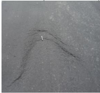
Imagen 7.1.6 Fisuración por deslizamiento
