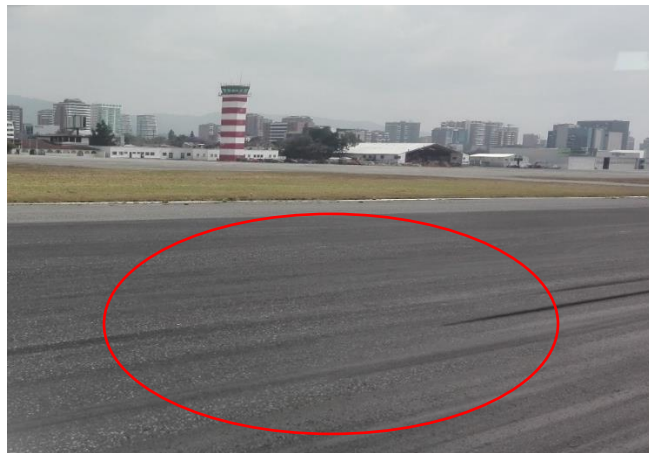
Imagen 7.4.2 Pérdida del Agregado fino de la pista
