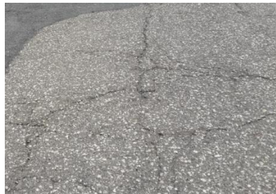
Imagen 7.1.4 Fisura en Bloque de la pista
