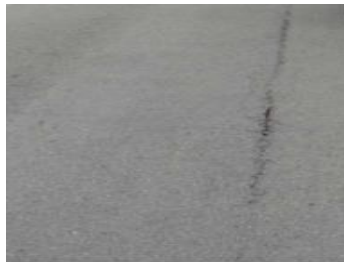
Imagen 7.1.2 Fisura Longitudinal en Junta de Construcción
