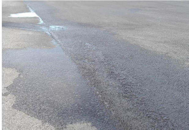
Imagen 7.2.3 Hundimiento en una pista
