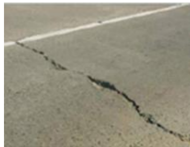
Imagen 7.6.1, falla por estallido
